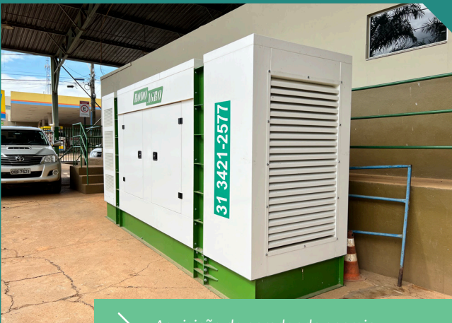
> Aquisição do gerador de energia
